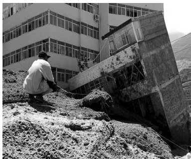
图 10-13 被泥石流冲垮的楼房
