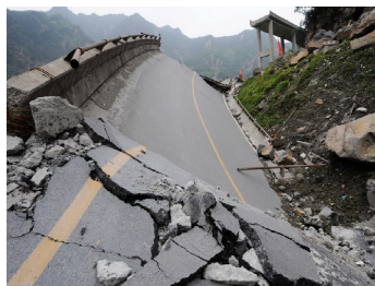
图 10-11 震后塌陷的公路
