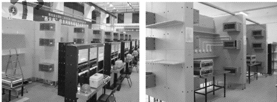
图 5-31 “西元”网络综合布线实训装置
