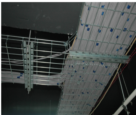
图 4-17 天花板吊顶内布线 2
