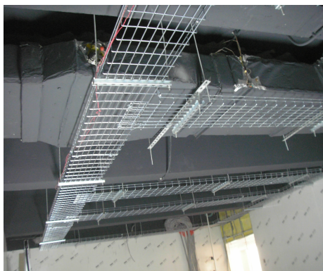
图 4-16 天花板吊顶内布线 1
